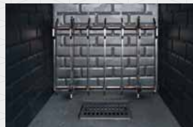
Camera di combustione con griglia sollevata
